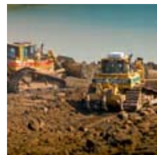
D6 buldožeri na djelu, dio voznog parka od 40 Catovih strojeva na terenu.
